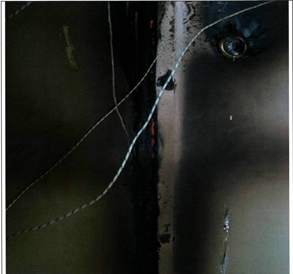
Foto 3. Ovangloed door de opschuimende strips te zien na 75 minuten
